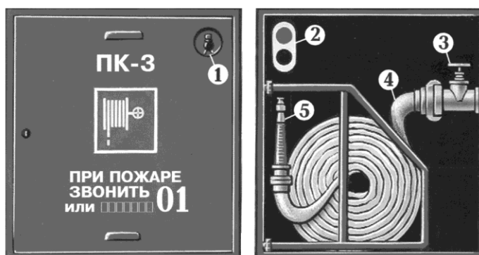
Рис. 10. Внутренний пожарный кран: 1 — место хранения ключа; 2 — пульт дистанционного включения насоса-повысителя; 3 — пожарный кран; 4 — пожарный рукав; 5 — ствол
